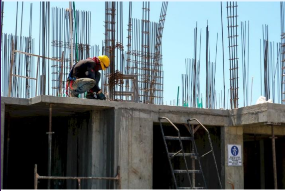
Construction d'un immeuble ; chacun a droit à un toit ! A nous -isolément et collectivement- de construire l'indispensable ...
